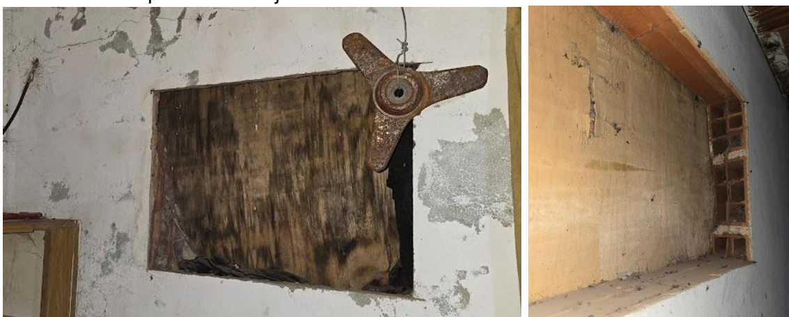
Figuras 16, y 17 – Vanos tapiados en muros laterales
