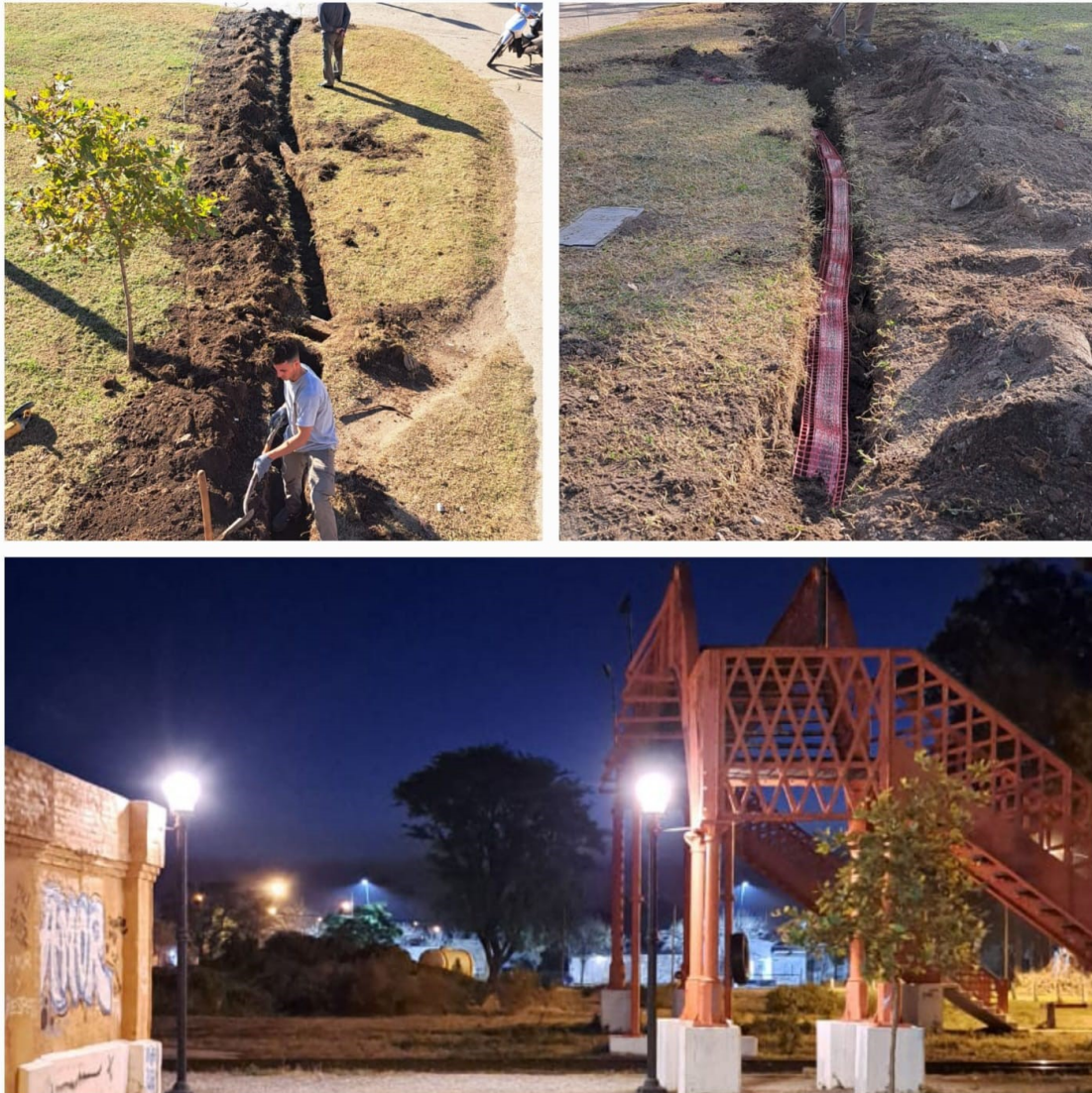
Figuras 138 y 139 – Mejoras en iluminación sector pasarela
